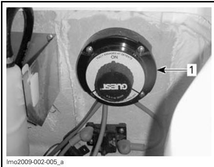
TYPIQUE — INTERRUPTEUR COUPE-CIRCUIT PRINCIPAL DE LA BATTERIE
