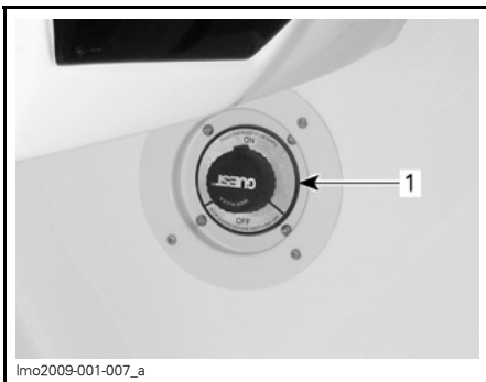
INTERRUTTORE BATTERIA PRINCIPALE
