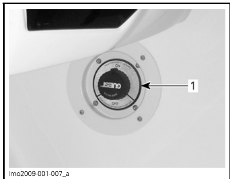
INTERRUPTOR DE DESCONEXIÓN DE LA BATERÍA PRINCIPAL
