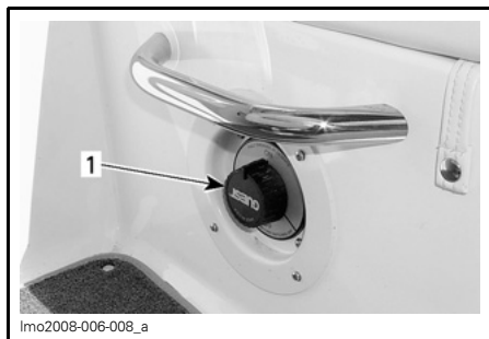
1. Interruptor principal de corte da bateria
