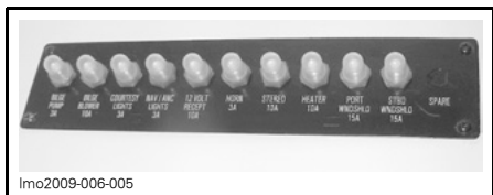
PAINEL DO DISJUNTOR DE CIRCUITO
