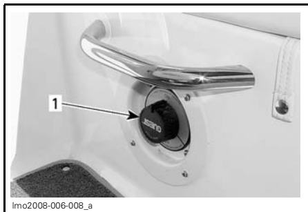
1. Interrupteur coupe-circuit principal de la batterie
