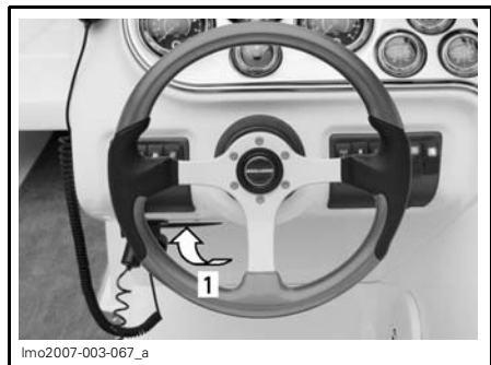
1. Emplacement du panneau à disjoncteurs
