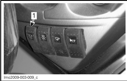
1. Interruttore luci di ponte
