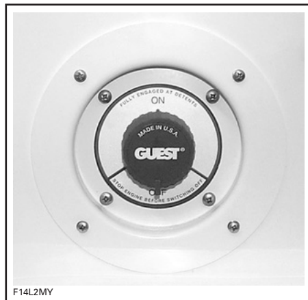
TÍPICO — INTERRUPTOR PRINCIPAL DE CORTE DA BATERIA
