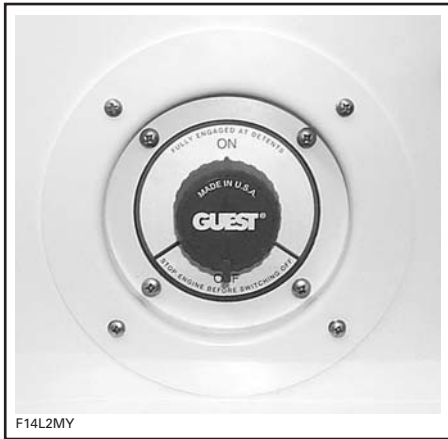
TIPIQUE — INTERRUPTEUR COUPE-CIRCUIT PRINCIPAL DE LA BATTERIE
