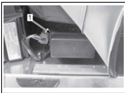
1. Boîte à fusibles
