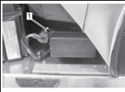
1. Boîte à fusibles
