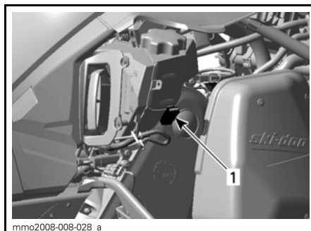
TYPEBILDE – HØYRE SIDE AV MOTORROM 1. 5 A sikring for start/REK
