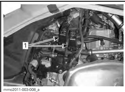
1. Boîtes à fusibles
