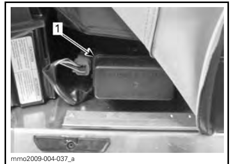
1. Boîte à fusibles
