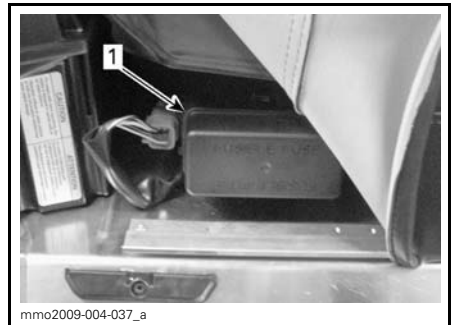
1. Boîte à fusibles
