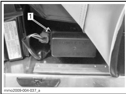
1. Boîte à fusibles
