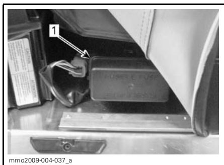
1. Boîte à fusibles
