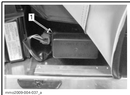
1. Boîte à fusibles
