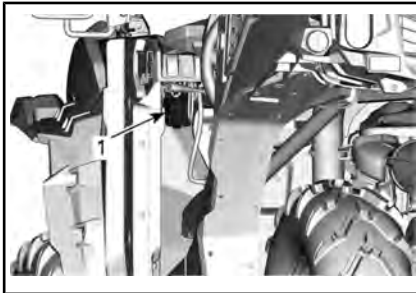
1. Caja de fusibles delantera
