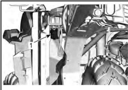
1. Boîte à fusibles avant
