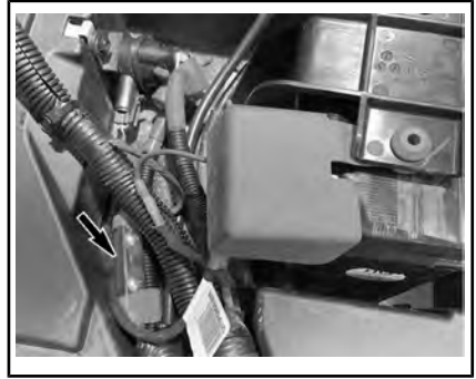
TYPIQUE - PORTE-FUSIBLE DU RÉGULATEUR
