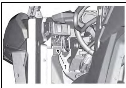
1. Передний блок предохранителей
