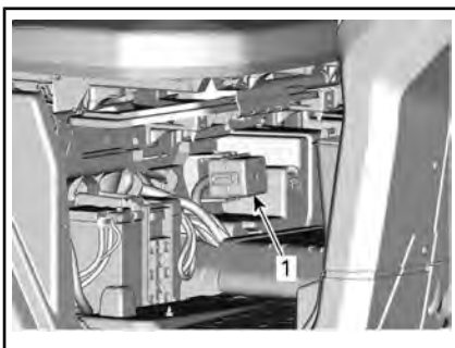
TAPA DE BATERÍA RETIRADA
