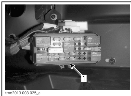
1. Boîte à fusibles principale
