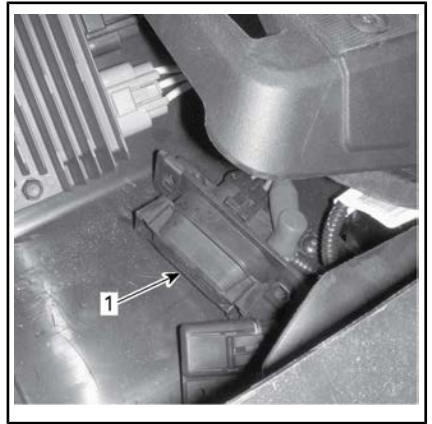
1. Caja de fusibles auxiliar
