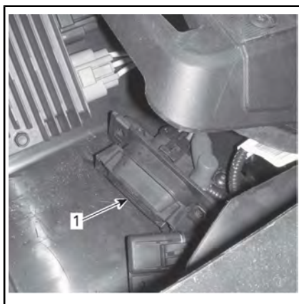
1. Caixa de fusíveis auxiliar
