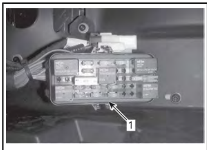
1. Caixa de fusíveis principal
