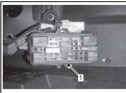
1. Caja de fusibles principal
