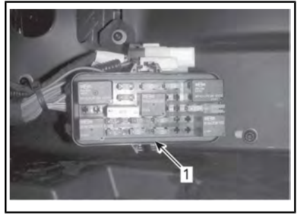
1. Caja de fusibles principal
