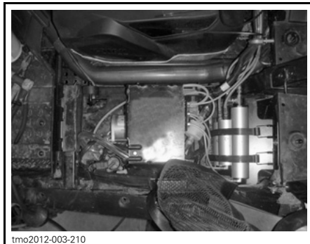
1. COMPRESSOR DA ACS
