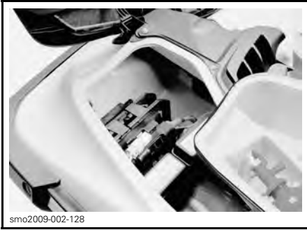
AKUN JA SULAKKEIDEN VAIHTAMINEN - OIKEANPUOLIMAINEN SÄILYTYSLOKERO IRROTETTUNA
