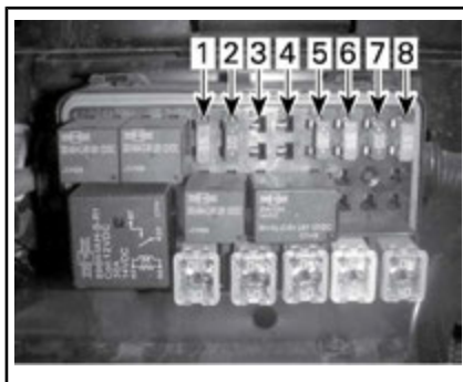
SICHERUNGEN - LINKER SICHERUNGSKASTEN
