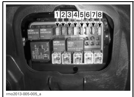
FUSIBLES - BOÎTE À FUSIBLE GAUCHE
