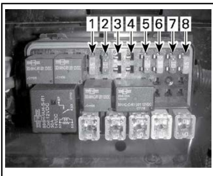
FUSIBLES: CAJA DE FUSIBLES IZQUIERDA
