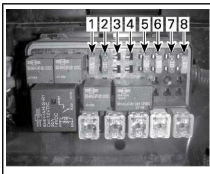
SICHERUNGEN - LINKER SICHERUNGSKASTEN
