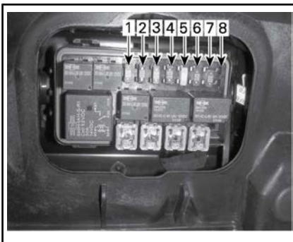
FUSÍVEL - CAIXA DE FUSÍVEL DIREITA
