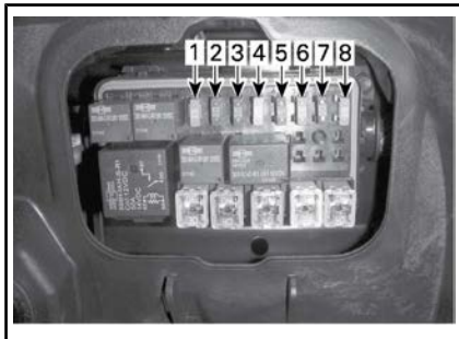
FUSÍVEIS - CAIXA DE FUSÍVEL ESQUERDA
