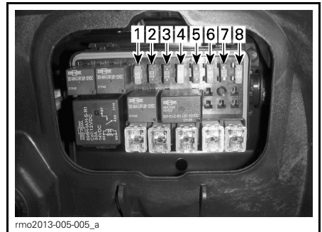
FUSIBLES - BOÎTE À FUSIBLE GAUCHE
