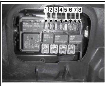
FUSIBLES: CAJA DE FUSIBLES DERECHA
