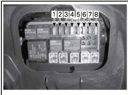
FUSIBLES: CAJA DE FUSIBLES IZQUIERDA
