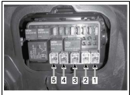
FUSIBLES HEMBRA: CAJA DE FUSIBLES IZQUIERDA
