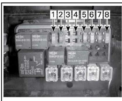
SÄKRINGAR - VÄNSTER SÄKRINGSBOX
