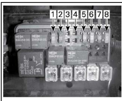
FUSIBILI - SCATOLA FUSIBILI SINISTRA
