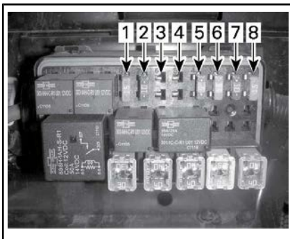
FUSIBLES: CAJA DE FUSIBLES IZQUIERDA
