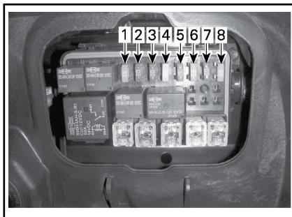
FUSÍVEIS - CAIXA DE FUSÍVEIS ESQUERDA
