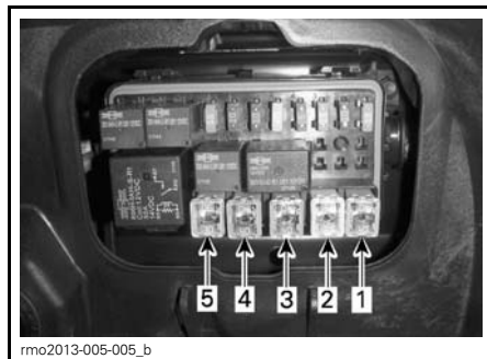
JCASE-SIKRINGER – VENSTRE SIKRINGSBOKS
