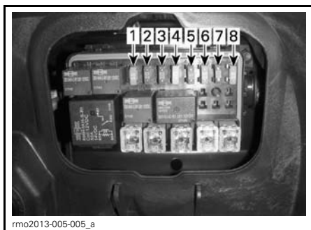
FUSIBLES - BOÎTE À FUSIBLE GAUCHE
