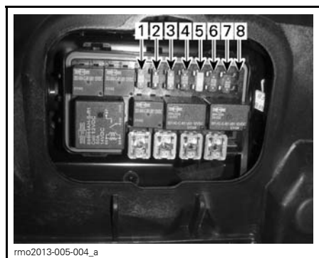
FUSÍVEIS - CAIXA DE FUSÍVEIS DIREITA
