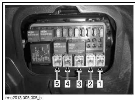
FUSÍVEIS JCASE - CAIXA DE FUSÍVEIS ESQUERDA
