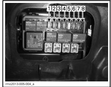
FUSIBLES - CAJA DE FUSIBLES DERECHA
