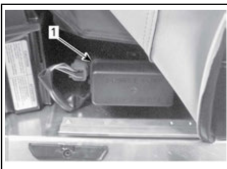
1. Boîte à fusibles
