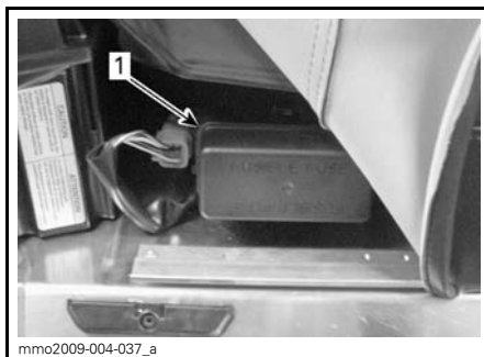
1. Boîte à fusibles
