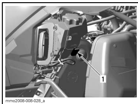
TYPBILD — HÖGER SIDA AV MOTORRUMMET
