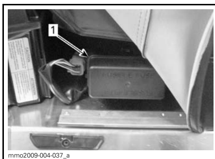
1. Boîte à fusibles
