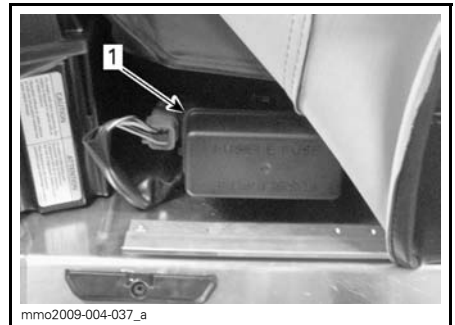
1. Boîte à fusibles
