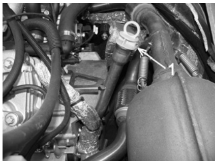
HØYRE SIDE AV MOTORROMMET
