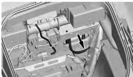
DC12 – FRÄMRE KABELFÖRBEREDELSE – BAKOM FÖRVARINGSUTRYMMET
